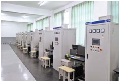
供用电实训室
